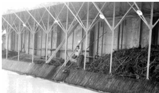
Dégrilleur avec son rateau
