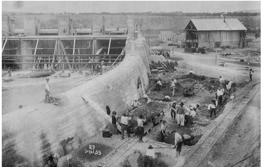
Construction de la chambre d'eau et de la salle des vannes en 1909
