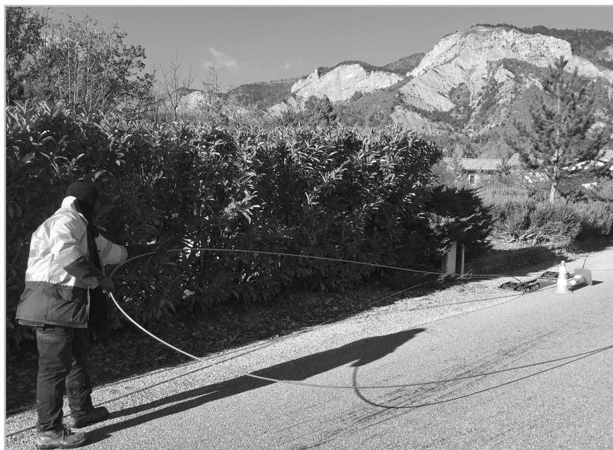
Opération "aiguillage" et tirage de la fibre dans les fourreaux France Télécom enfouis dans la route du Villard
